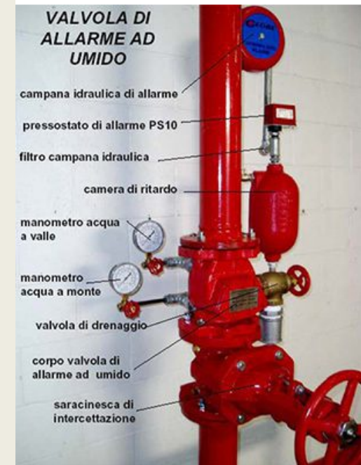
Sistema sprinkler a umido NAMIRAL o similari
